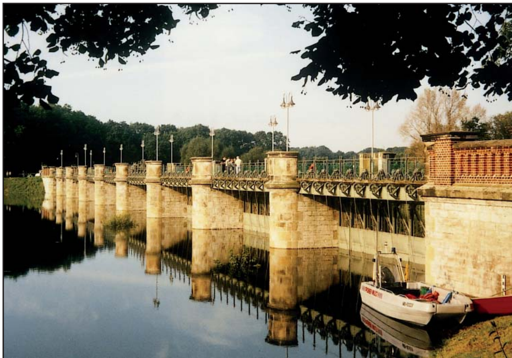
Abb. 17: Schützentafelwehr Pretzien im Elbeumflutkanal (Foto: M. Simon)
